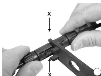
Figura 34 - Exemplo de desconexão com a ferramenta adequada
